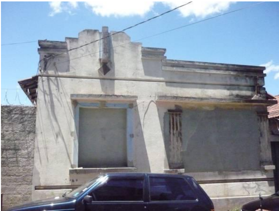
Casa do bairro Lagoinha, muda e surda, com portas e janelas concretadas.
